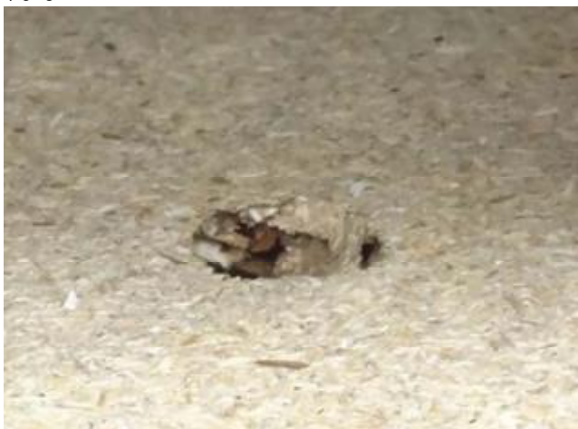
写真-6 Pc-3「試験終了後」
