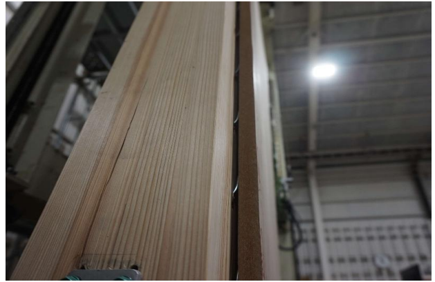
くぎの引抜け
