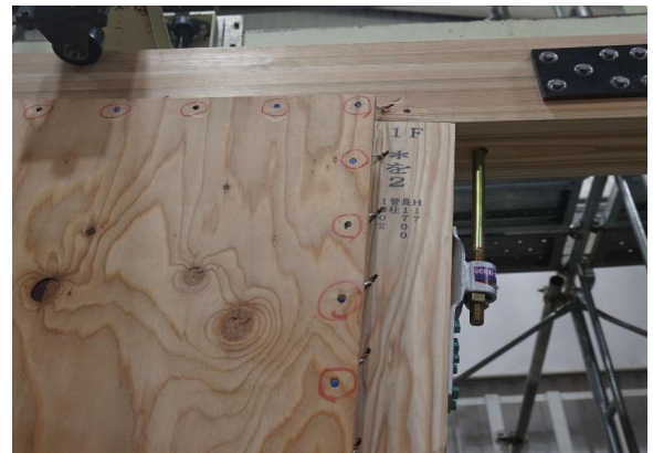
くぎの引抜け
