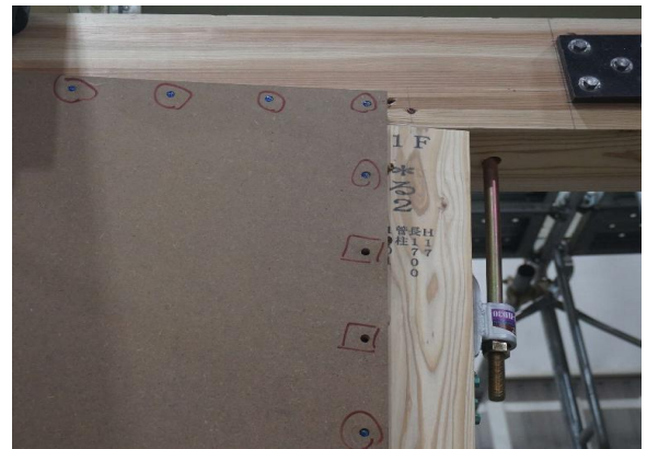
くぎの引抜け
