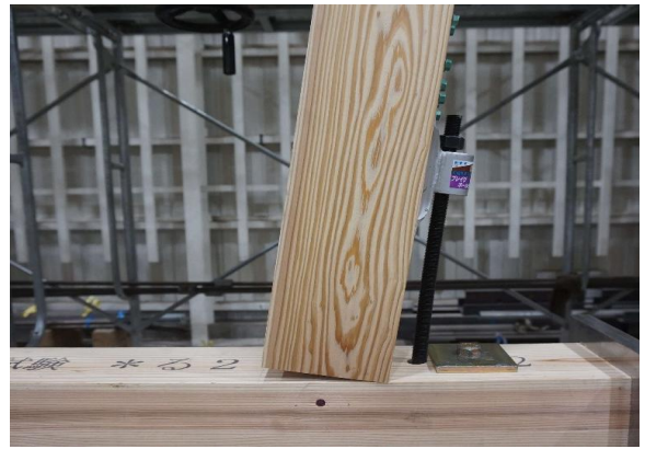
柱の浮き上がり
