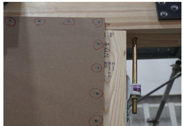
くぎの引抜け
