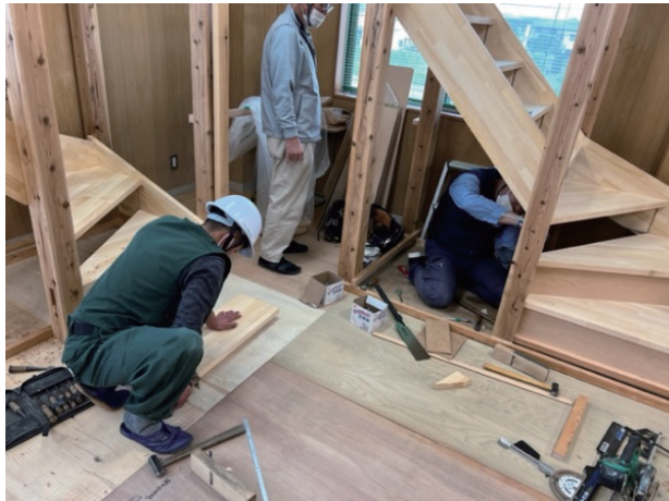
長期・集中訓練 2022年10月9日 茨城県連(水戸) Lv2(実技) 直階段・折れ階段の加工・組立
