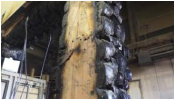
写真 5. 3. 2-13 柱の座屈箇所 (非加熱面／柱中央から 150mm 上)
