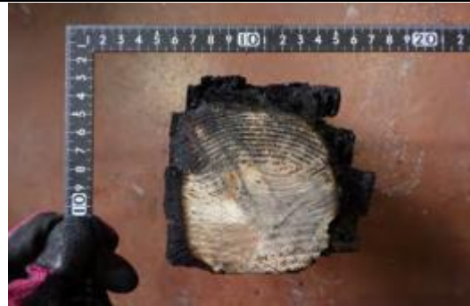
写真 5. 3. 2-32 柱の座屈箇所 (見上げ／上：加熱面, 下：非加熱面)
