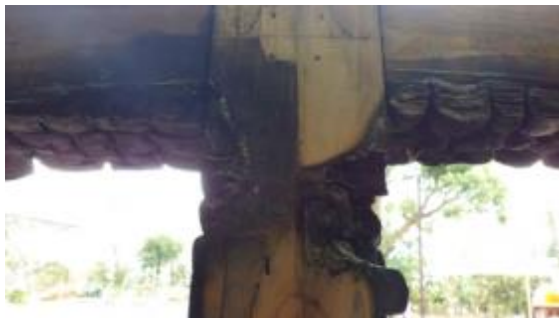
写真 5. 3. 2-31 柱の座屈箇所 (非加熱面／受け材芯から 100mm 下)
