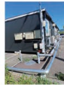
裏廻り配管・浄化槽
