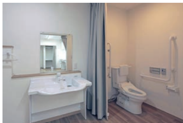
写真10 バリアフリータイプの洗面とトイレ
