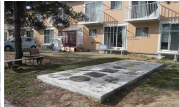
写真8 宝立町第2団地（埋設型浄化槽）
