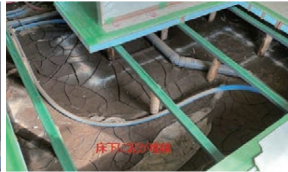
応急仮設住宅の被災状況（浦上第1団地（輪島市））
