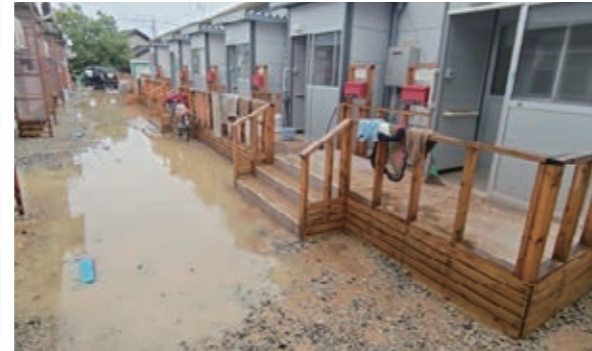
応急仮設住宅の被災状況（上戸町第2団地（珠洲市））
