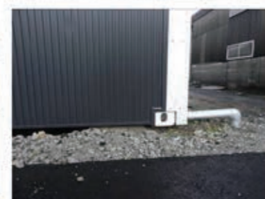
ユニット基部
