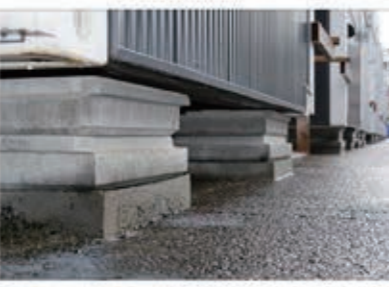
PC 架台(舗装面上)
