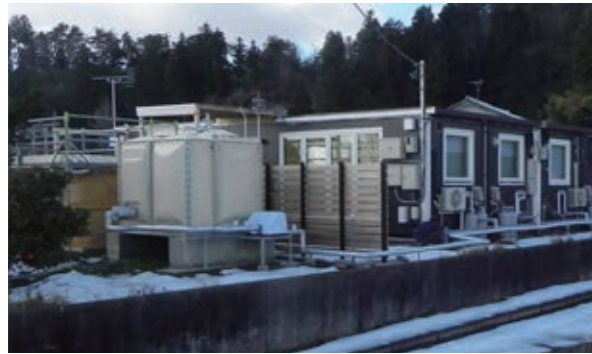
写真7 上戸町第4団地（受水槽・地上式浄化槽）
