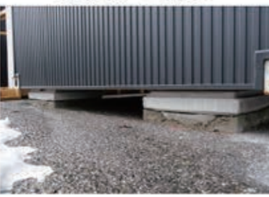
PC 架台(舗装面上)
