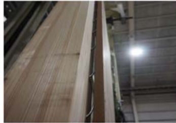
くぎの引抜け
