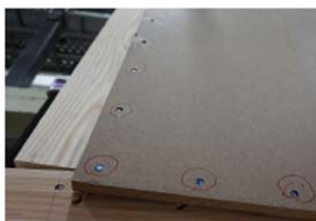
くぎの引抜け
