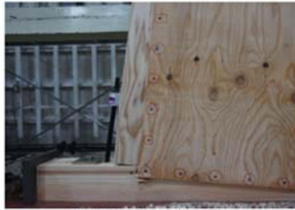
面材の縁切れ、くぎの引抜け
