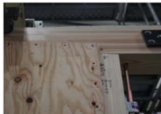
くぎの引抜け
