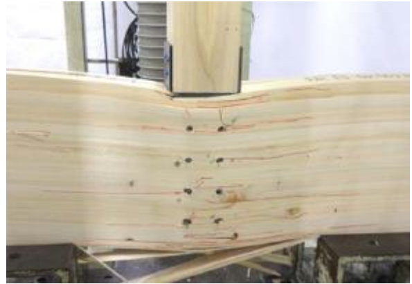
金物のめり込み、桁の割れ
